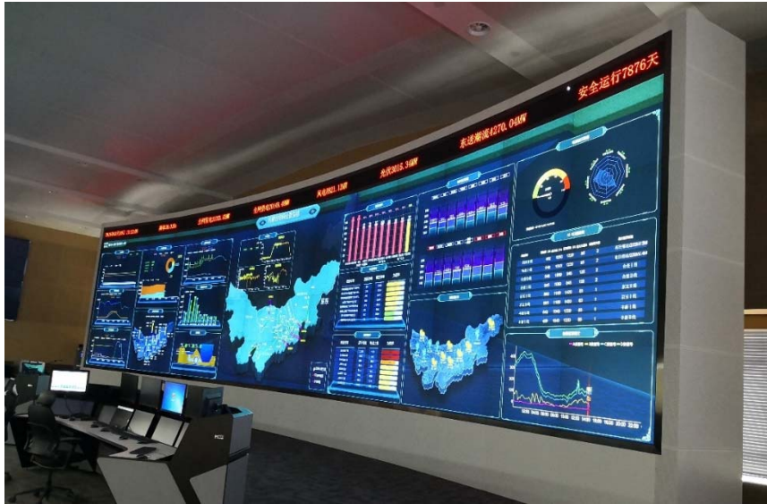
图 6：电力调度指挥中心现场图
